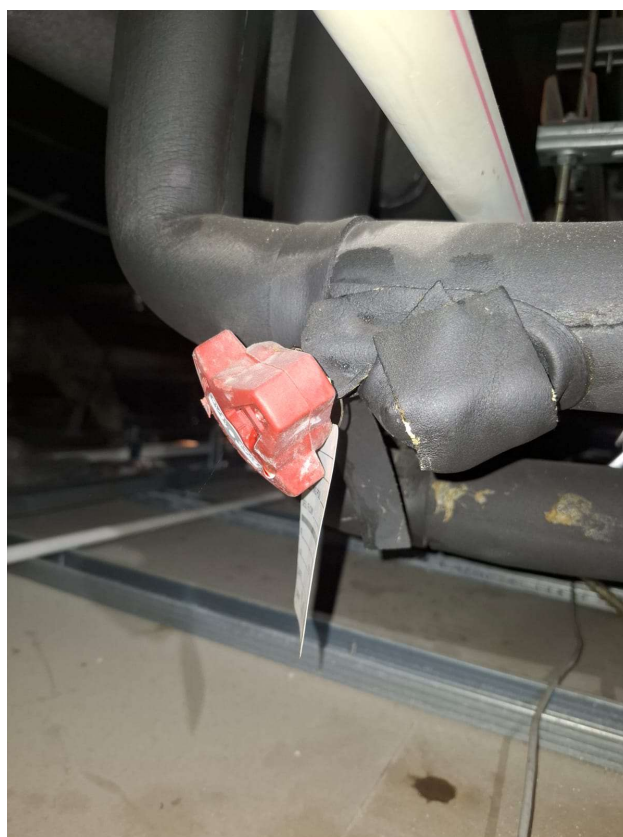
Zdjęcia przedstawiają stan techniczny instalacji i sufitów
