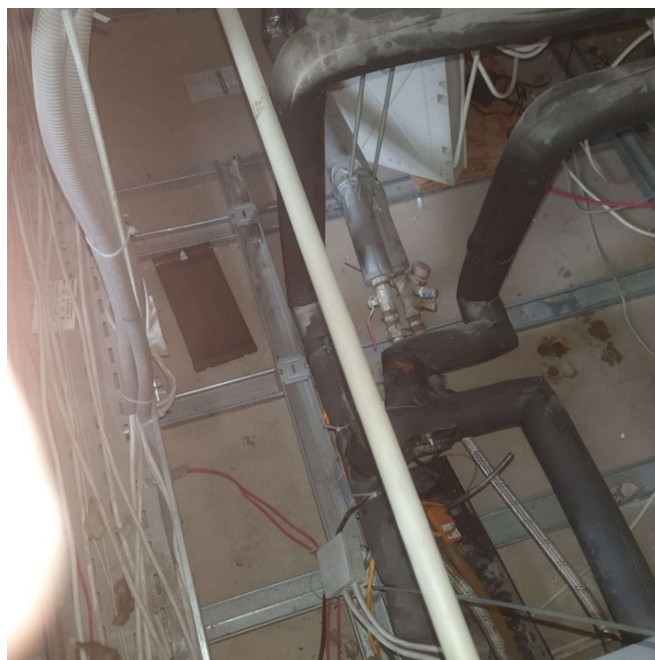
Zdjęcia przedstawiają stan techniczny instalacji i sufitów
