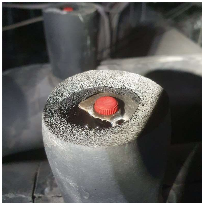
Zdjęcia przedstawiają stan techniczny instalacji i sufitów
