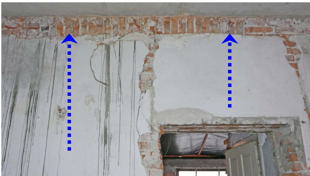
Fot. nr 16. Kraków, Plac Kossaka 4, parter, pom. nr 1.2, ujęcie w kierunku północnym, poniżej współcześnie wprowadzonego żelbetowego stropu, powstałego w czasie ostatniej akcji budowlanej w samoistnych ubytkach w tynku widoczny fragment uwidocznionego nadproża dawnego okna, w ścianie elewacyjnej północnej, por. il. nr VI. Fot. M.J.Łukacz 2020 r.
