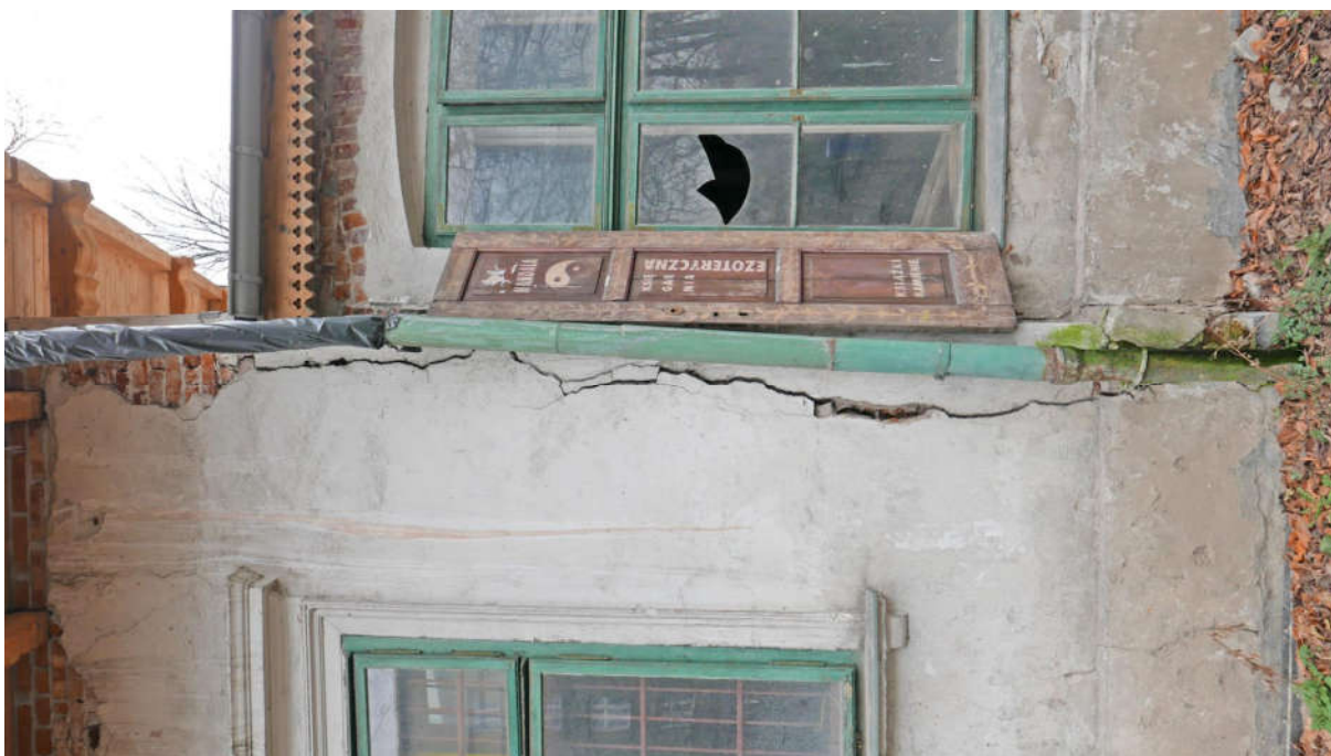
Fot. nr 12. Kraków, Plac Kossaka 4, elewacja południowa, partia wschodnia, widoczne konstrukcyjne odspojenie narożnika oraz nieznaczne osunięcie się skrzydła zabudowy względem linii poziomej. Fot. M.J.Łukacz 2020 r.
