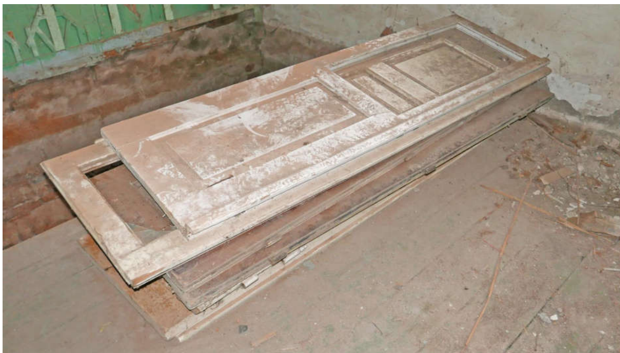
Fot. nr 65. Kraków, Plac Kossaka 4, parter, pom. nr LU.1.1, widoczne zdemontowane sztuki drzwi o konstrukcji płycinowej z częściowo zachowanymi zawiasami typu francuskiego oraz z nie zachowanym szkleniem wybranych pól (nr el. zab. I – D) Fot. M.J.Łukacz 2020 r.
