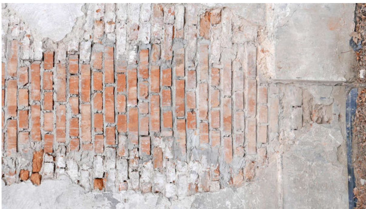
Fot. nr 10. Kraków, Plac Kossaka 4, elewacja zachodnia, partia środkowa w poziomie parteru, widoczne przemurowanie partii wstępu w partii dostawionego aneksu zachodniego przy użyciu cegły maszynowej oraz zaprawy cementowo - wapiennej o znacznej sile wiązania. Fot. M.J.Łukacz 2020 r.
