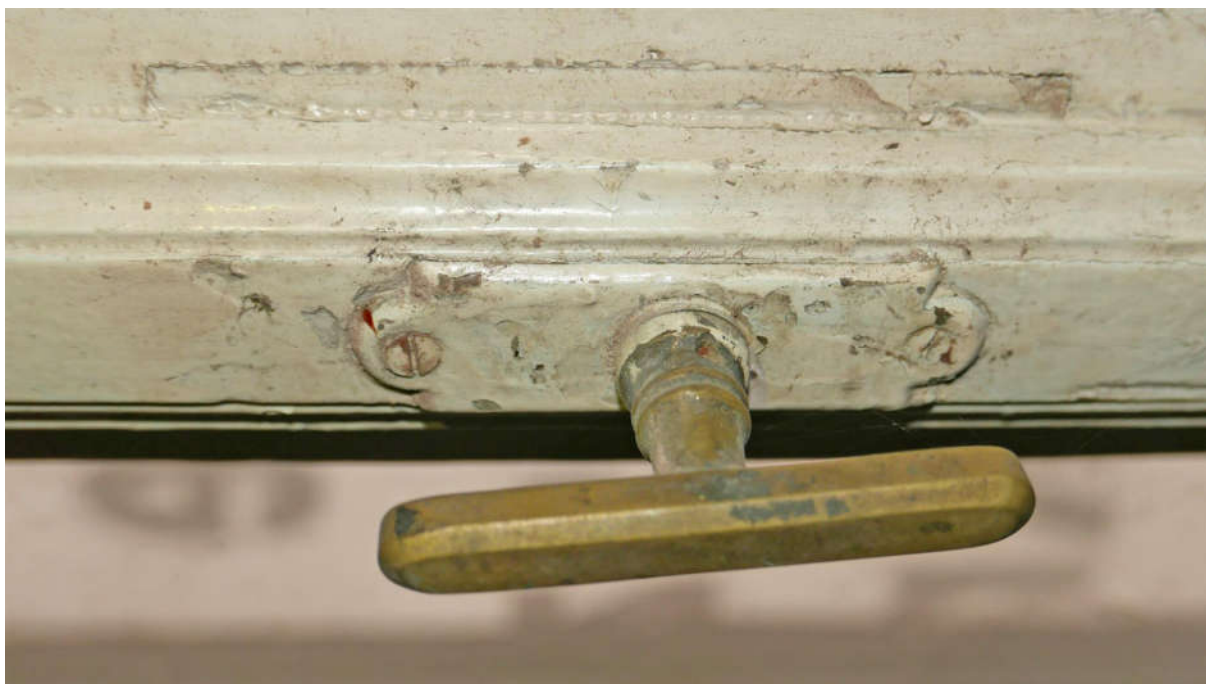
Fot. nr 43. Kraków, Plac Kossaka 4, poddasze, pom. nr 2.10, widoczna zachowana mosiężna klameczka oraz szyldzik stolarki okiennej w typie (nr el. zab. I-O3) Fot. M.J.Łukacz 2020 r.
