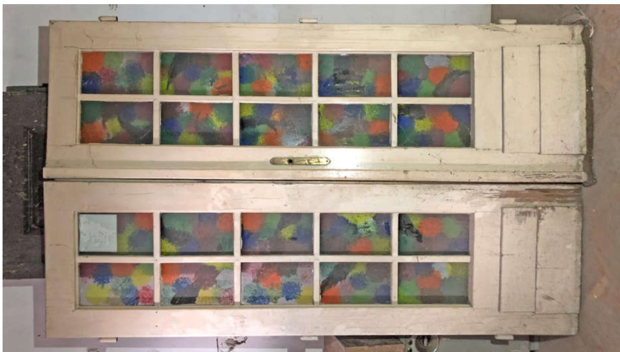
Fot. nr 69. Kraków, Plac Kossaka 4, parter, pom. nr, 2.1, widoczna zdemontowana płycinowa stolarka przeszklonych drzwi dwuskrzydłowych, 20-sto polowych - o wtórnie przemalowanych szybkach, z dolnymi sekcjami w postaci brudników (o identycznej formie jak zewnętrzne skrzydła drzwi balkonowych w pom. nr 2.9, por. fot. nr 40) ( nr el. zab I - D7 ) Fot. M.J.Łukacz 2020 r.
