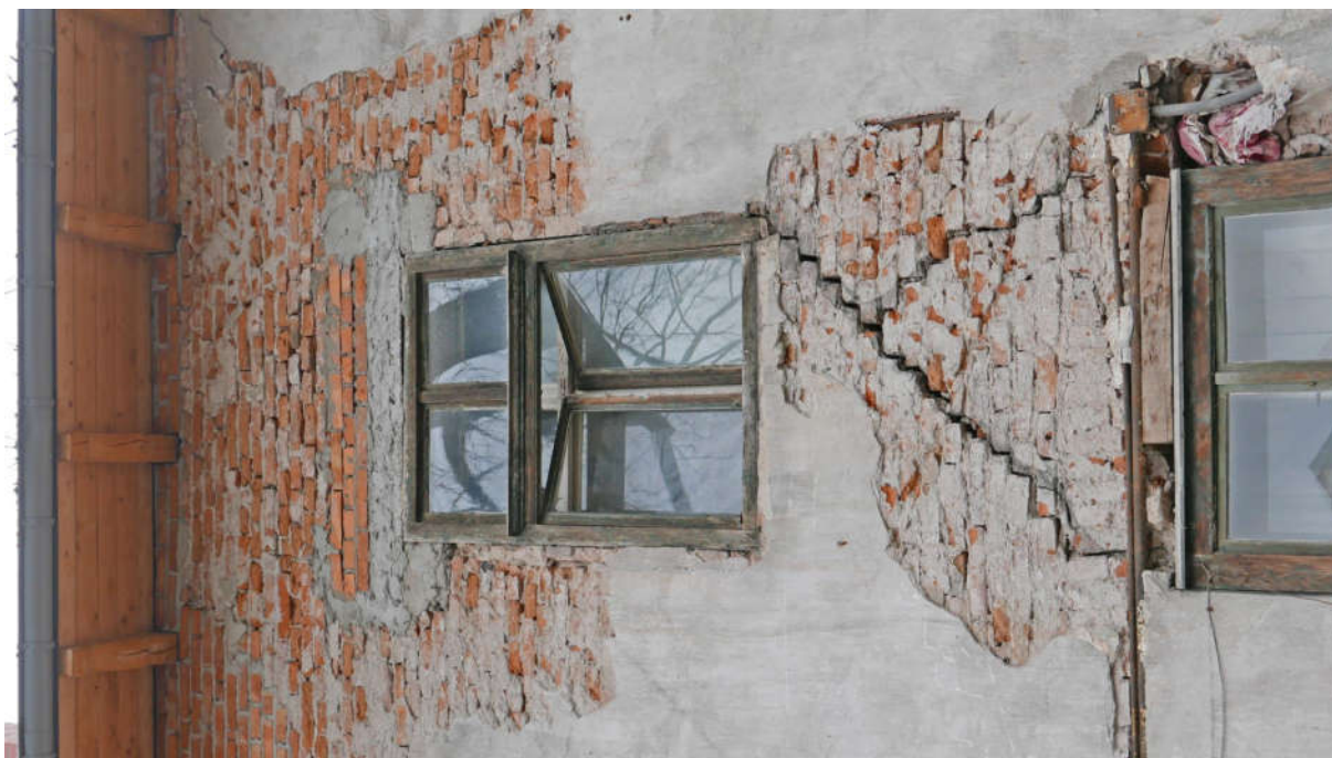
Fot. nr 11. Kraków, Plac Kossaka 4, elewacja zachodnia, fragment w poziomie kondygnacji poddasza użytkowego, czytelne rozległe ubytki tynku oraz przemurowanie wątku w partii nadproża okiennego w poziomie poddasza przy użyciu cegły maszynowej oraz zaprawy cementowo - wapiennej, niżej konstrukcyjne pęknięcia i ubytki wgłębne wątku ponad oknem w poziomie parteru; widoczna stolarka okienna w poziomie poddasza (nr el. zab. I-O3) Fot. M.J.Łukacz 2020 r.
