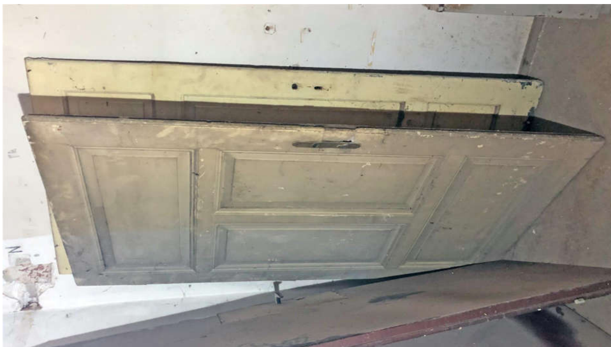
Fot. nr 70. Kraków, Plac Kossaka 4, parter, pom. nr, 2.1, widoczna zdemontowana płycinowa stolarka drzwi jednoskrzydłowych z zachowanymi zawiasami typu francuskiego w typie stolarki drzwiowej nr el. zab. I - D4 . Fot. M.J.Łukacz 2020 r.
