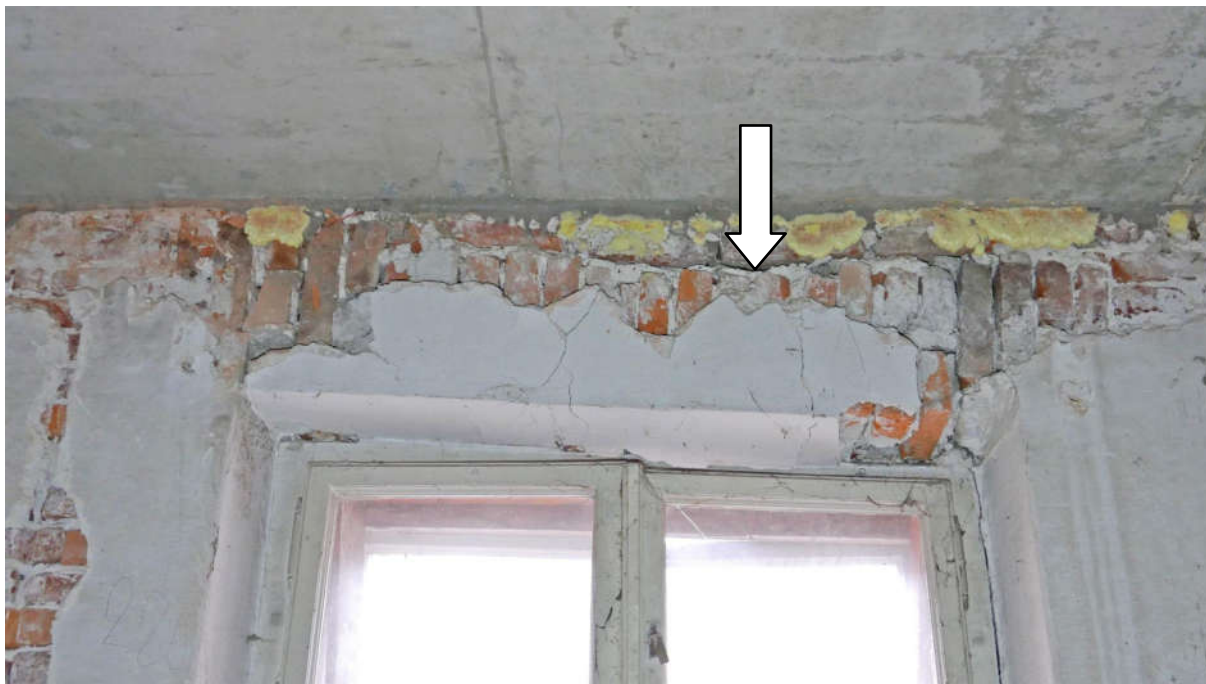
Fot. nr 17. Kraków, Plac Kossaka 4, parter, pom. nr 1.2, ujęcie w kierunku północnym, poniżej współcześnie wprowadzonego żelbetowego stropu, powstałego w czasie ostatniej akcji budowlanej w samoistnych ubytkach w tynku widoczny fragment uszkodzonego statycznie nadproża okna, wymurowanego z cegły. Fot. M.J.Łukacz 2020 r.
