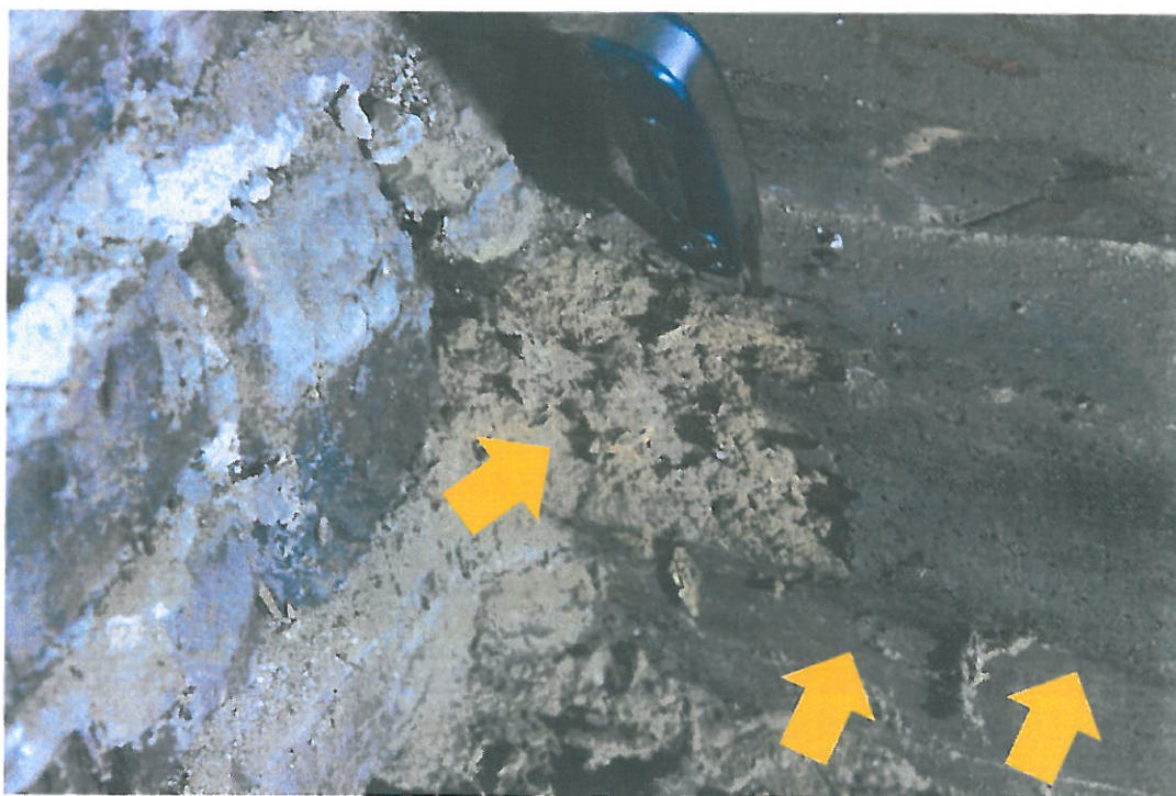
Fot. 7 Na desce nadbitej na belce liczne otwory wylotowe owadów – technicznych szkodników drewna. W tym konkretnym przypadku: kołatek domowy ( Anobium punctatum ). Deska utraciła parametry wytrzymałościowe w miejscu porażenia.
