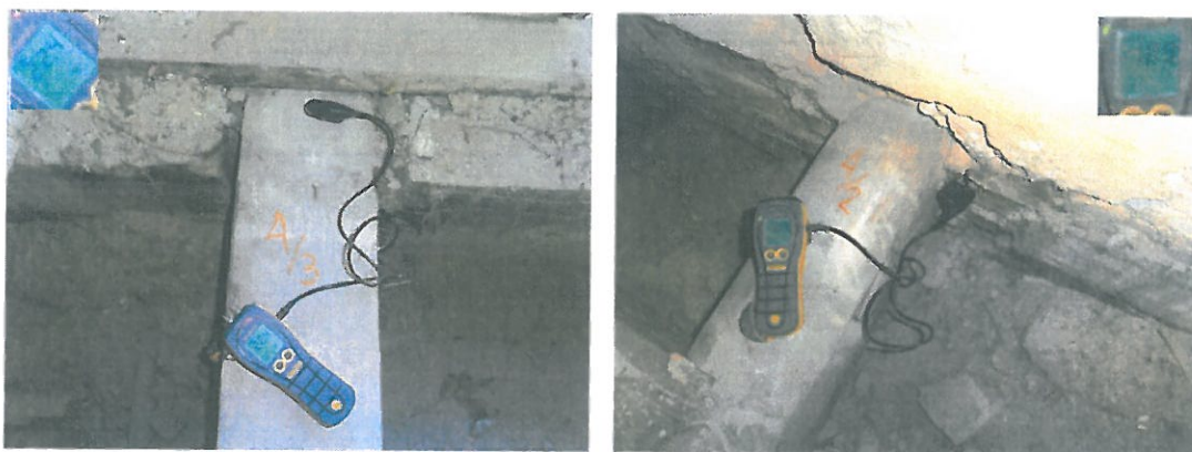
Fot. 21, 22 Pomiar wilgotności belek nr 2 (po prawej) i nr 3 (po lewej). Wilgotność strukturalna drewna: 10,9% (belka 4/2) – drewno suche oraz 22,4% (belka 4/3) - drewno mokre.
