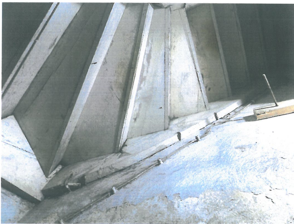
Fot. 3, 4 Na belkach spocznikowych zamocowanych do ściany liczne otwory wylotowe owadów – technicznych szkodników drewna.
