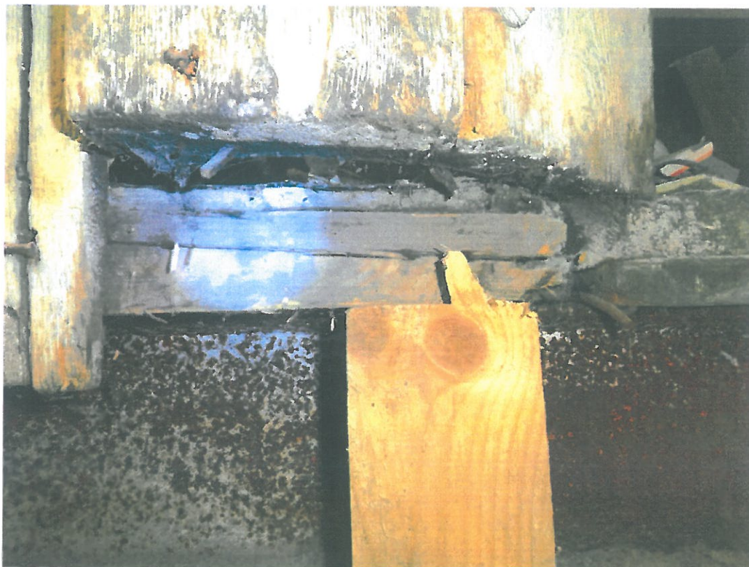
Fot. 7 Na dolnej części konstrukcji słupa spocznika liczne otwory wylotowe owadów – technicznych szkodników drewna. W tym konkretnym przypadku: kołatek domowy ( Anobium punctatum ).
