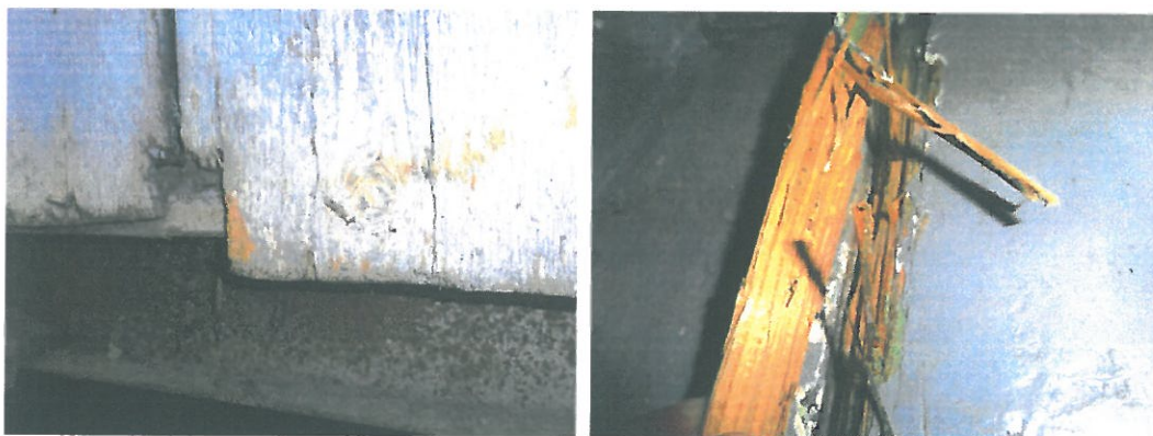
Fot. 8, 9 Na deskach opierzenia w części przyposadzkowej, a także w górnej części przy balustradzie liczne otwory wylotowe kołatka domowego. Po usunięciu wierzchniej warstwy drewna widoczne korytarze larwalne.
